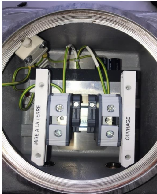
Câblage Cellule BCC ATEX monocâble (réf. E101894)
